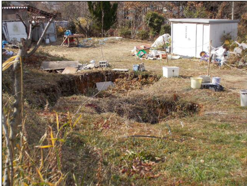
写真 5.1 地表の陥没状況
